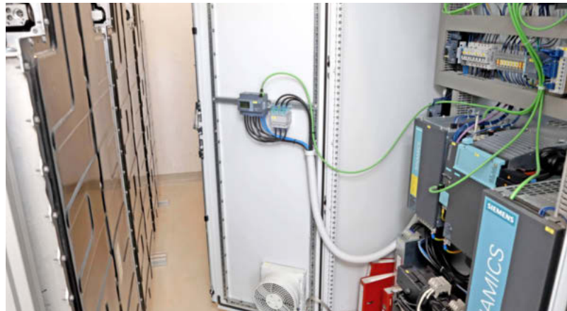
Der Technikraum mit den gebrauchten Batterien von E-Autos (links), die die Ladestationen mit Strom versorgen, aber auch als Speicher genutzt werden können.
